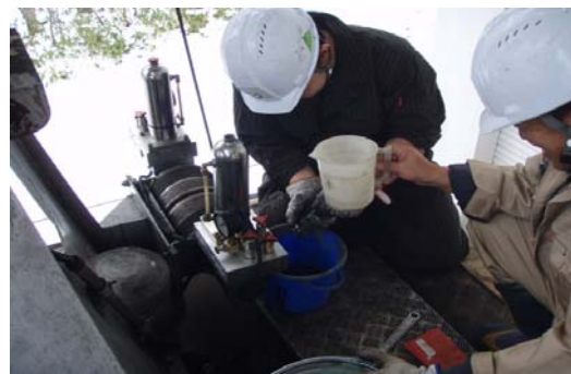
搬器揺れ減衰装置オイル交換
