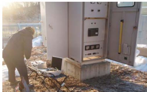
高圧ケーブル診断
